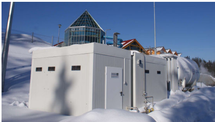
Stacja regazyfikacji LNG – Termy Bukowina SPA
