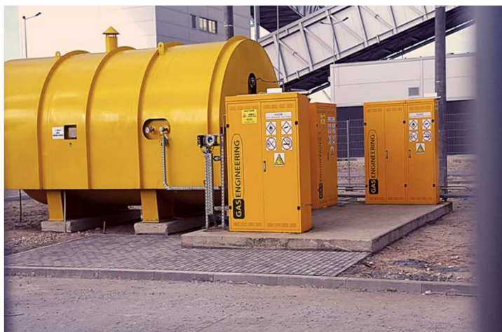
Układ wodoru do chłodzenia generatora – Elektrownia Kozienice
