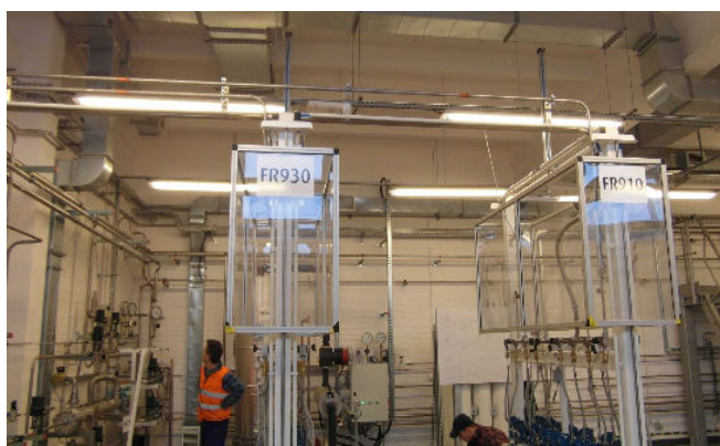
Rampy pełnienia butli – Linde Tarnów
